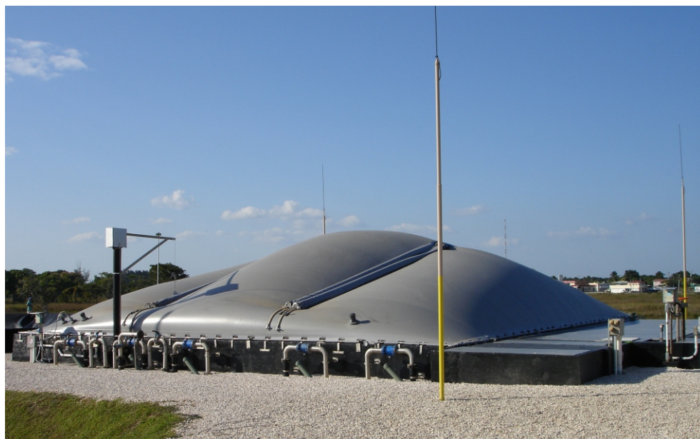
Planta BIOLAK®GAS Liquid para productora de bebidas, aprox. 1.200 m 3 /d, 2.450 kg DQO/d
